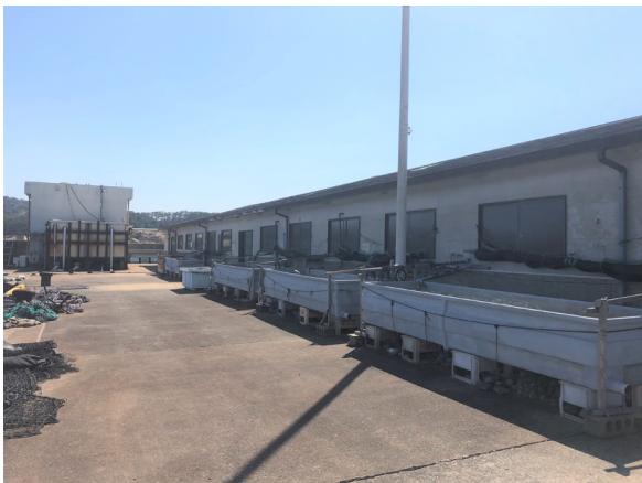
設置後すでに27年経過しています
