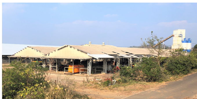
台風の被害が大きかった旧家畜市場
