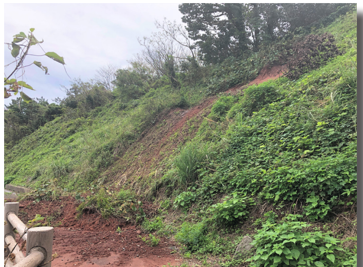
最近も崩れた岳の内調整池の法面
