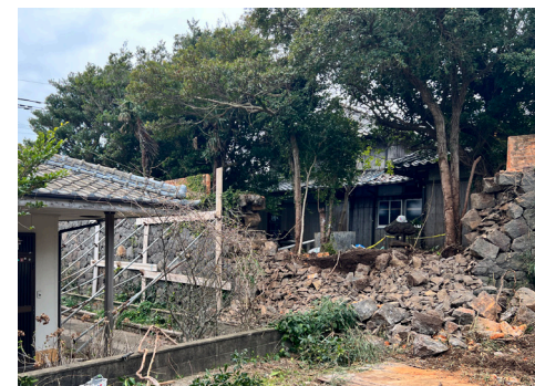
災害直後、石垣が大きく崩れている
