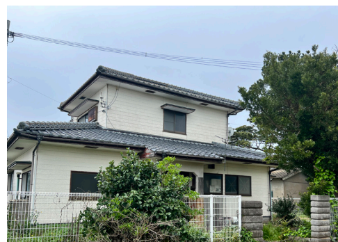
施工前、雨漏り等で痛みが激しかった
